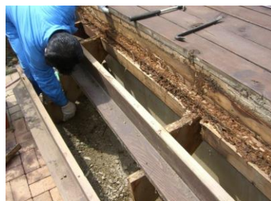
外観からは気づかなかったデッキ廻り。幕板を剥がしてビックリ!!
